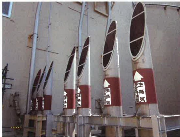
図 3 主蒸気安全弁（排気管）の設置状況
