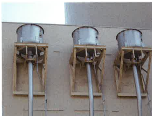
図3 主蒸気逃がし弁消音器の設置状況
