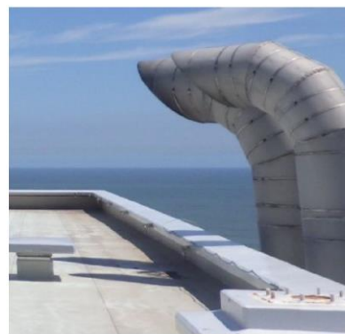
第5図 ディーゼル発電機排気管
