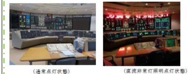
(通常点灯状態) (直流非常灯照明点灯状態)
