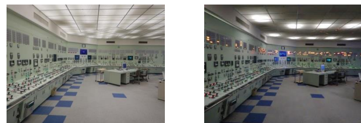
(通常点灯状態) (直流非常灯点灯状態)
