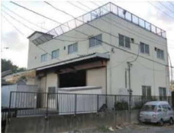
屋上フェンスの変形
