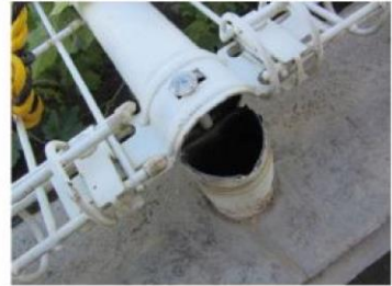
フェンス支柱部の破損
