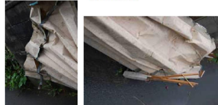
飛散した折板屋根の状況
