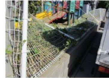
フェンスの変形
