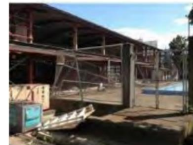
フェンスの被害 (工事中の建築物)
