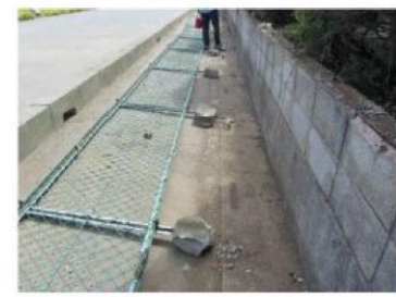
フェンスの倒壊
