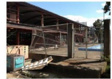
フェンスの変形 (工事中の建築物)
