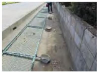
フェンスの倒壊
