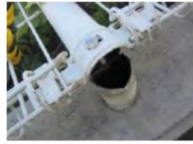
支柱部の破断
