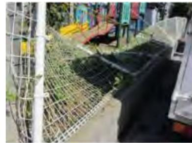
フェンスの倒壊
