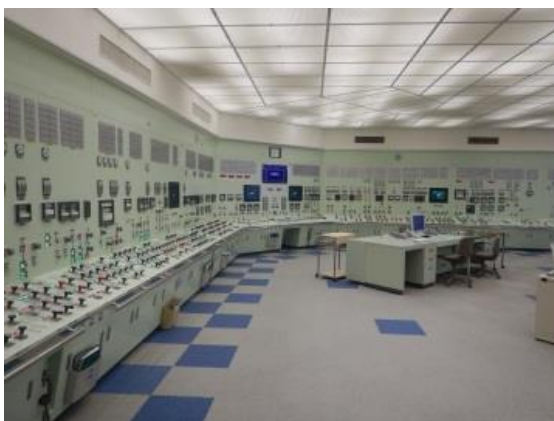
(通常点灯状態)
