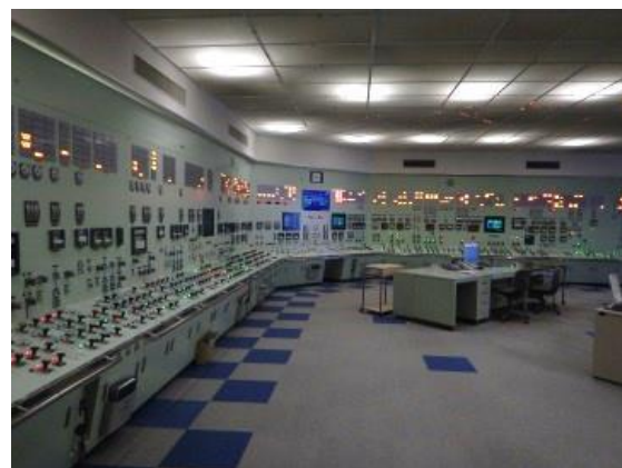
(直流非常灯点灯状態)
