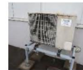
④-14 空調室外機
