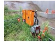
③-3 仮設分電盤
