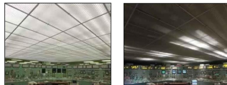
(通常点灯状態) (直流非常灯点灯状態)
