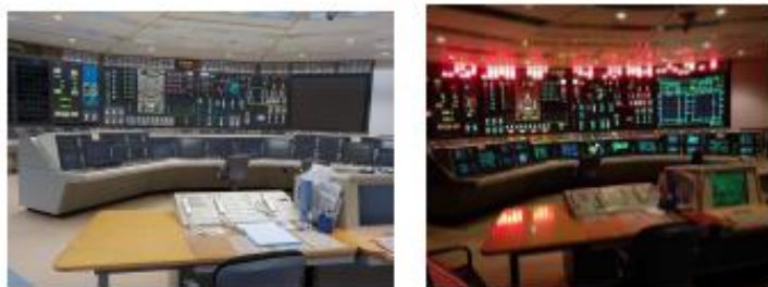
(通常点灯状態) (直流非常灯照明点灯状態)
