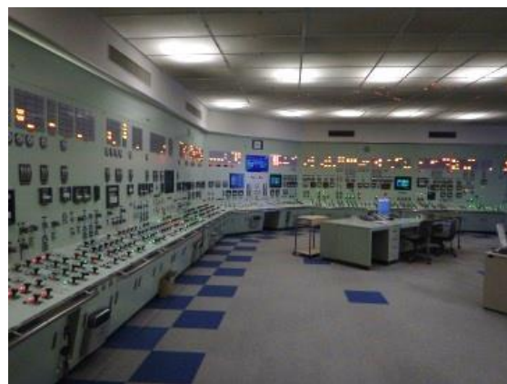
(直流非常灯点灯状態)
