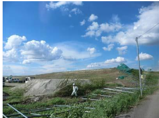
写真 5.2.20 フェンスの被害
