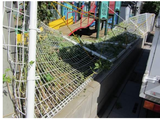
写真 4.1.14 フェンスの倒壊
