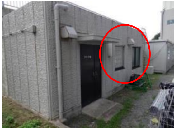
71 プロワ室ガラス窓
