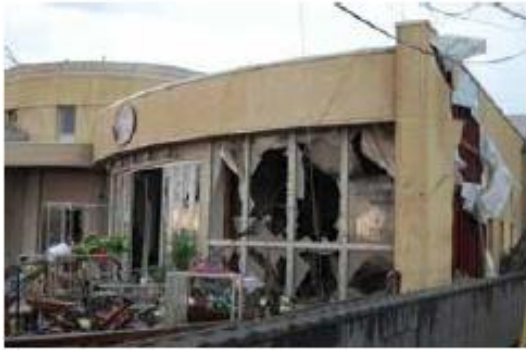
写真 3.4-21 店舗の窓ガラスの被害状況
