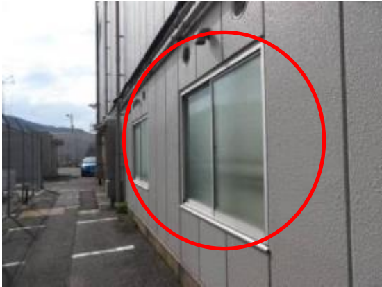
68 サイトパンカ建物ガラス窓（1）
