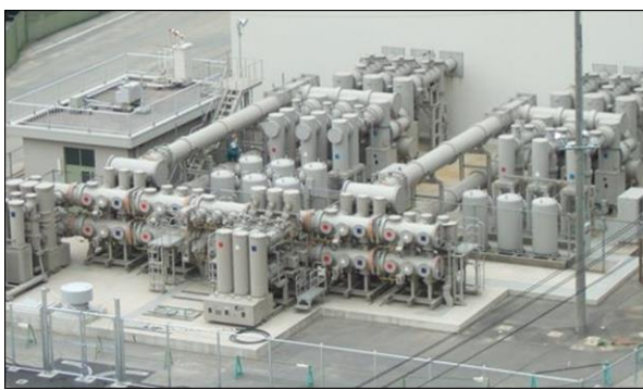
ガス絶縁開閉装置（220kV）
