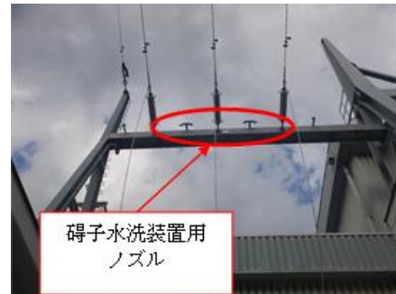
66kV 送電線（開閉所出口）
