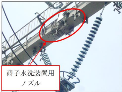
220kV 送電線（開閉所出口）
