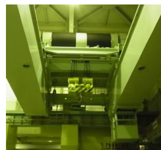
原子炉建物天井クレーン
