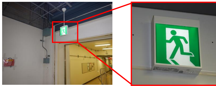
避難口誘導灯
