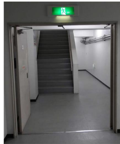
避難口誘導灯
