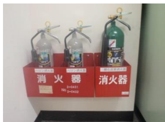
消火器設置状況
