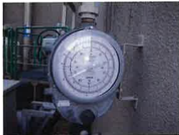
図 1 復水タンク水位計
