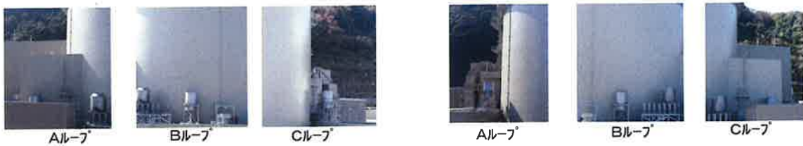
図3 主蒸気逃がし弁消音器の設置状況（左3号炉、右4号炉（各3系統））
