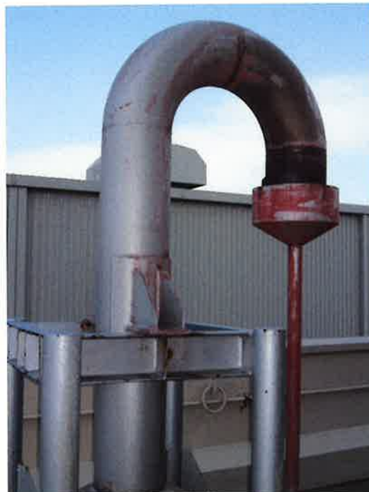
図 1 タービン動補助給水ポンプ蒸気大気放出管の設置状況
