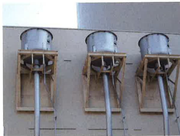
図3 主蒸気逃がし弁消音器の設置状況
