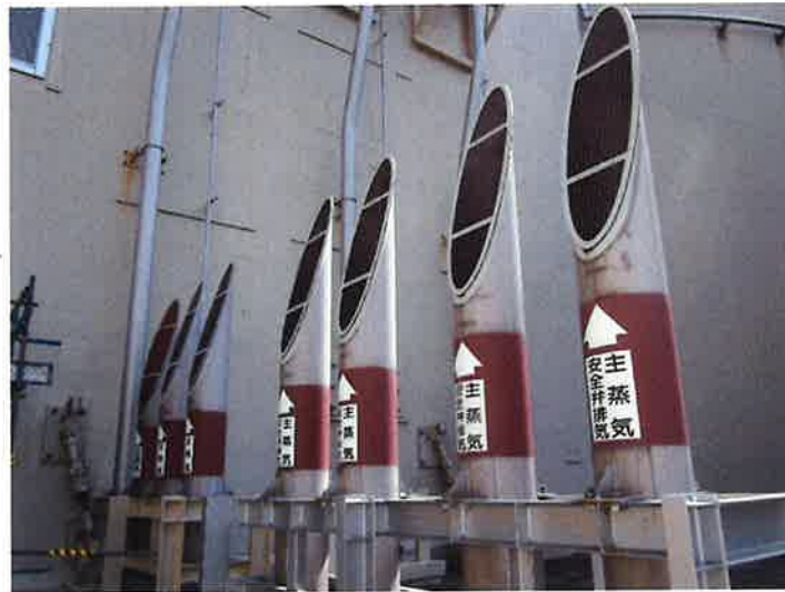
図3 主蒸気安全弁（排気管）の設置状況
