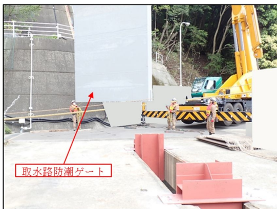
① 取水路防潮ゲートを角落し開口部に挿入した状態から吊り上げ、所定の場所へ移動。
