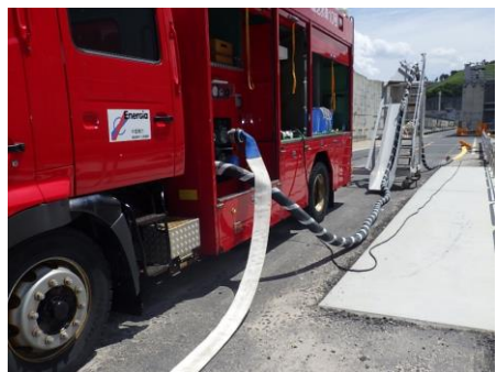
吸管・ホース・水中ポンプ設置完了後(模擬) (EL8.5m 2号炉取水槽付近)
