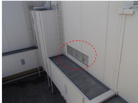
第 5-2 図 中央制御室換気系の外気取入口
