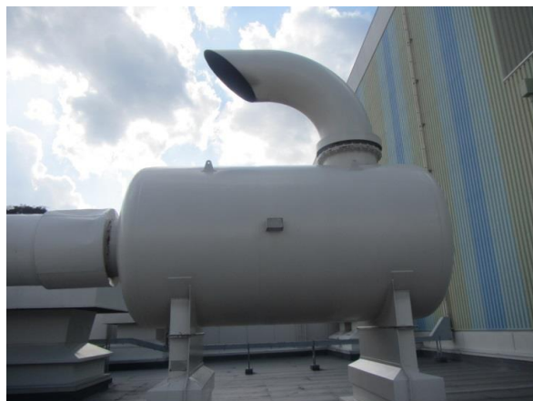
第3-4図 ディーゼル発電機排気消音器及び排気管
