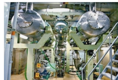
重水ポンプ室
