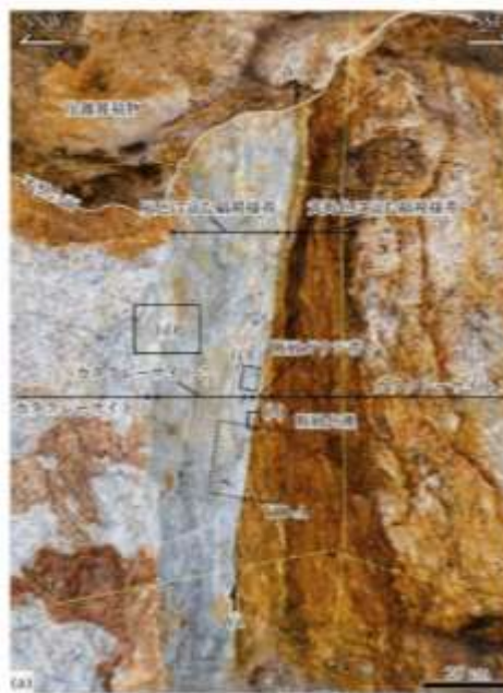
図-4 Y1近傍の断層面や断層帯の写真
