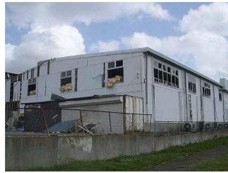
写真 16 窓ガラスの破損
