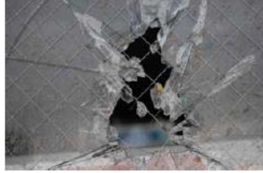
写真 3.4-36 ガラスへの飛来物の衝突痕
