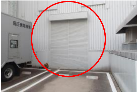
96 1号開閉所南側シャッター
