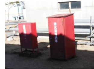
#152 消火設備格納箱
