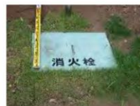
③-10 消火栓蓋
