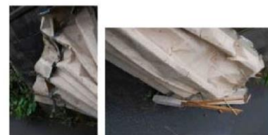
飛散した折板屋根の損傷状況
