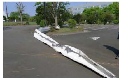
飛散した鋼板製屋根材
