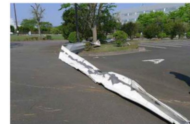
飛散した鋼板製屋根材
