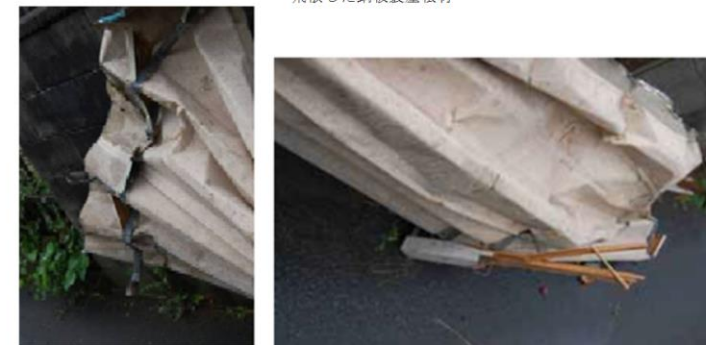
飛散した折板屋根の状況
