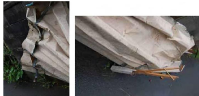
飛散した折板屋根の状況
