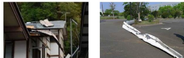
飛来物 (鋼板製屋根材) の衝突
