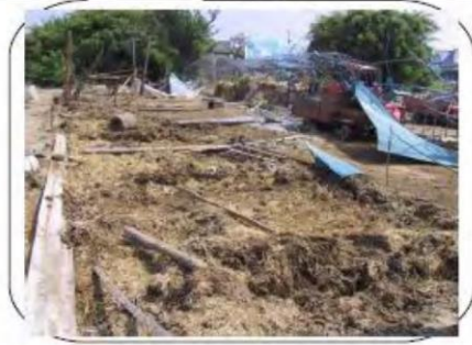
牛舎の屋根東方向、柱・トタン板は西方向に飛散している
