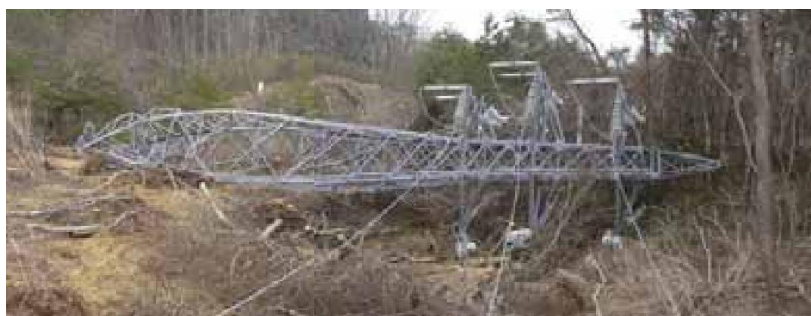
地震による斜面の崩落に伴う送電鉄塔の倒壊事例 ※2
