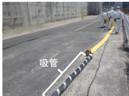
吸管・ホース設置状況(模擬) (EL8.5m 2号炉取水槽付近)
