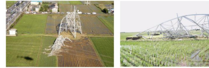
強風による送電鉄塔の倒壊事例① *1
