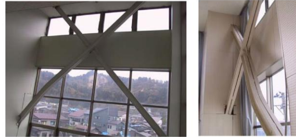
ブレース材の座屈
