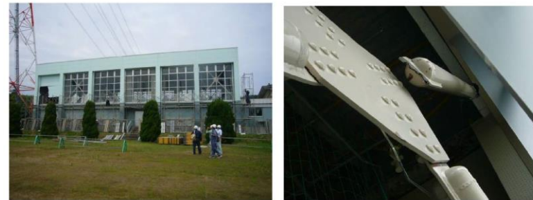
外観 筋かい材プレート破断
