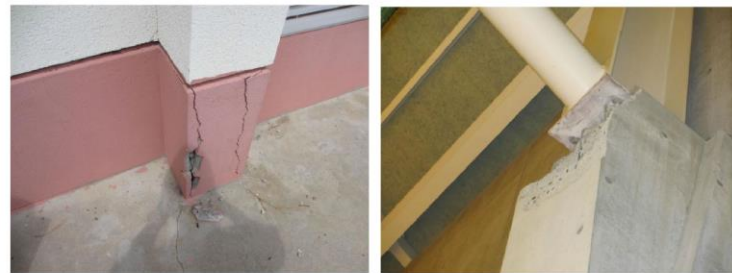
柱脚部コンクリートのひび割れ
