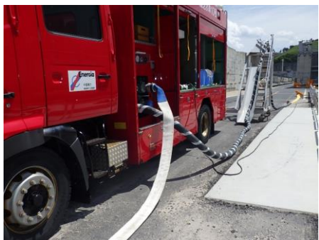
吸管・ホース・水中ポンプ設置完了後(模擬) (EL8.5m 2号炉取水槽付近)
