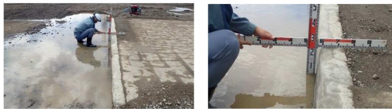
復旧前の段差状況
