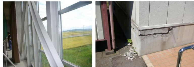
筋かい材の座屈 (刈羽村) 柱脚部コンクリートの割れ・剥落 (長岡市)
