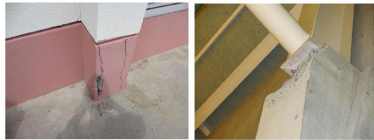
柱脚部コンクリートのひび割れ
