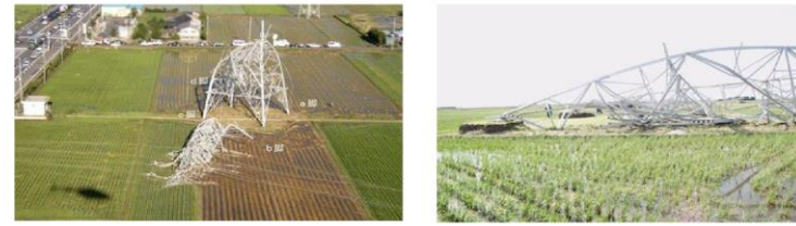
強風による鉄塔の倒壊事例① *1 強風による鉄塔の倒壊事例② *1
