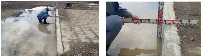
復旧前の段差状況
