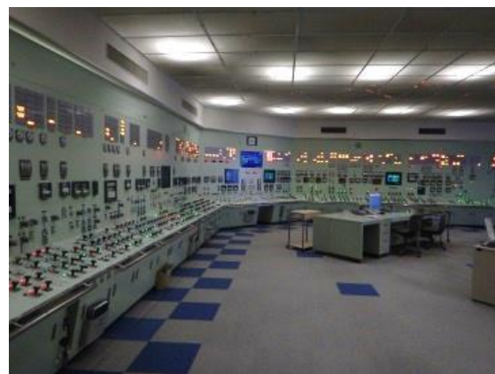
(直流非常灯点灯状態)
