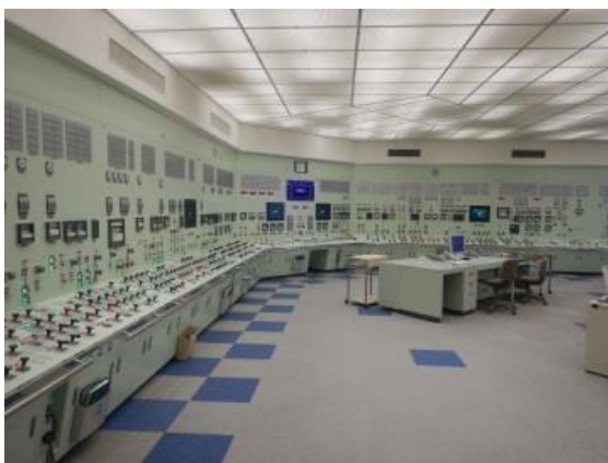
(通常点灯状態)
