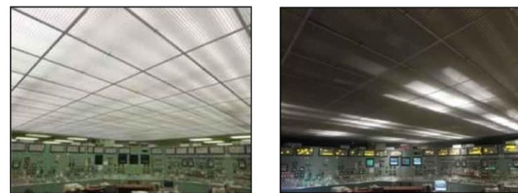
(通常点灯状態) (直流非常灯点灯状態)
