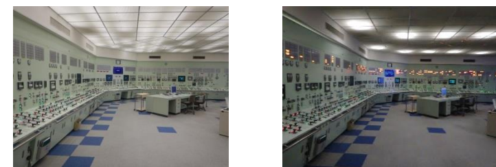
(通常点灯状態) (直流非常灯点灯状態)
