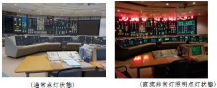
(通常点灯状態) (直流非常灯照明点灯状態)
