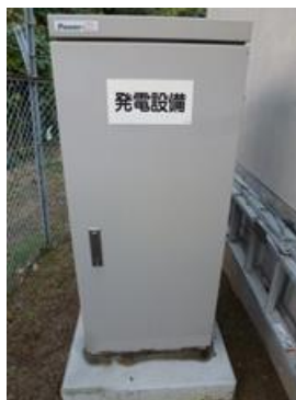
(非常用発電機の写真)
