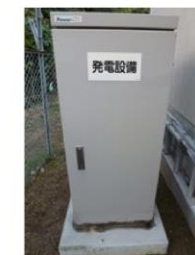
(非常用発電機の写真)
