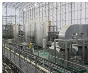
処理水タンク・供給タンク
