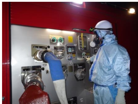
ポンプ起動操作（夜間）
