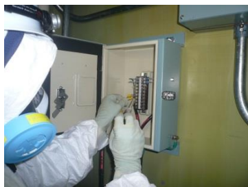
ADS 仮設電源接続 中継端子箱へ接続
