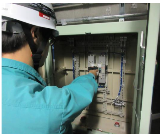
電源切替操作
