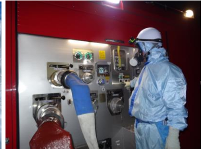
ポンプ起動操作（夜間）
