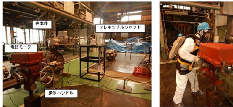
ベント操作（遠隔手動弁操作機構）
