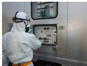
高圧発電機車での作業
