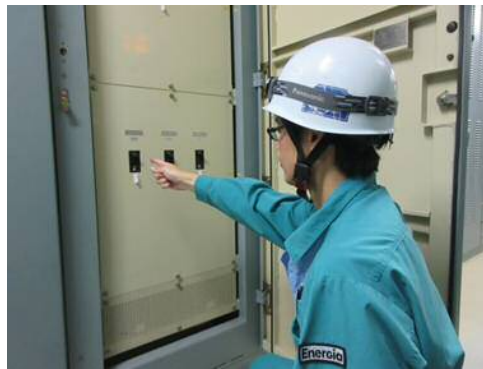
電源切替操作
