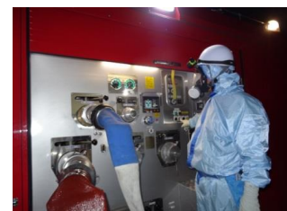
ポンプ起動操作（夜間）
