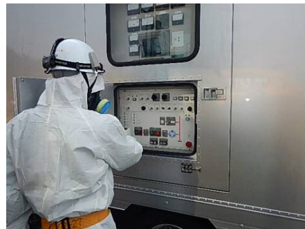
高圧発電機車での作業
