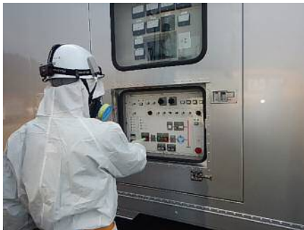
高圧発電機車での作業
