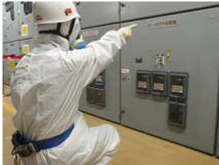
遮断器手動投入
