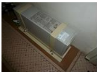
(無停電電源装置の写真)
