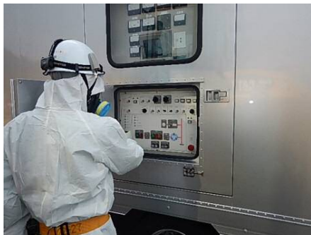
高圧発電機車での作業
