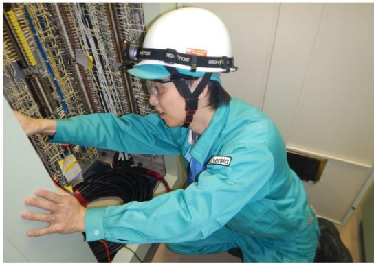
可搬型計測器接続
