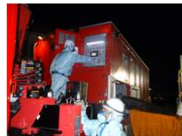
ポンプ起動操作（夜間）
