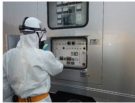
高圧発電機車での作業
