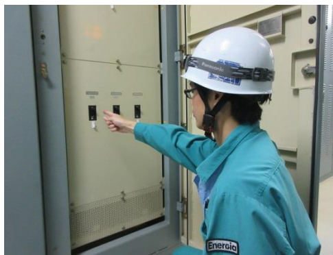
電源切替操作
