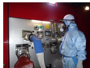
ポンプ起動操作（夜間）
