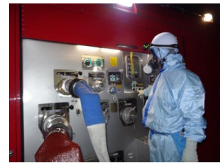
ポンプ起動操作（夜間）
