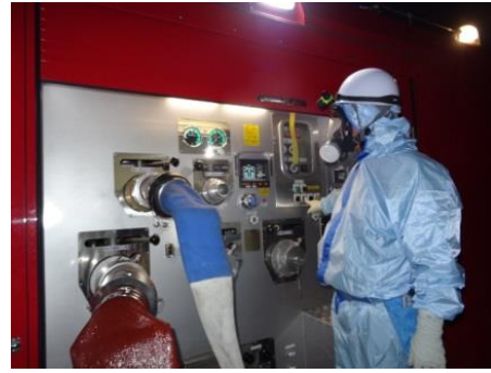
ポンプ起動操作（夜間）
