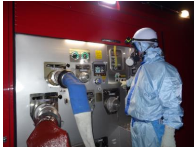
ポンプ起動操作（夜間）
