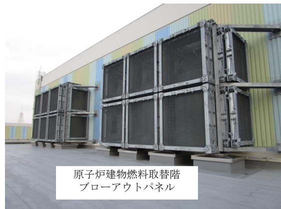
原子炉建物燃料取替階ブローアウトパネル
