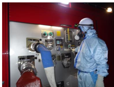
ポンプ起動操作（夜間）
