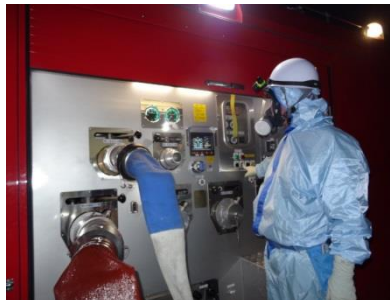
ポンプ起動操作（夜間）
