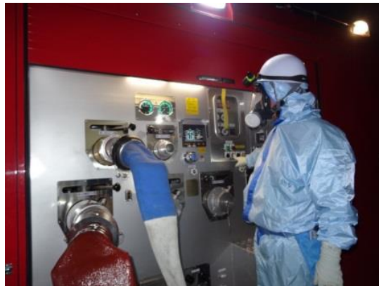
ポンプ起動操作（夜間）
