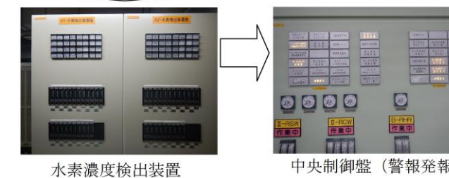
第 41-1-4 図 蓄電池室内の水素濃度検知器の設置状況
