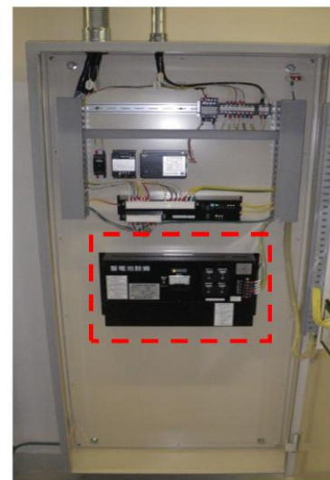
第 41-1-31 図 二酸化炭素自動消火設備 (全域) 制御盤内蓄電池
