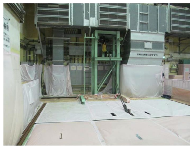
第1図 大物搬入ロハッチの閉状態
