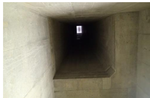
A-給気消音器フィルタ室内
