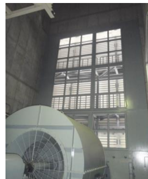
HPCSディーゼル室送風機 及び火山灰対策（フレーム）
