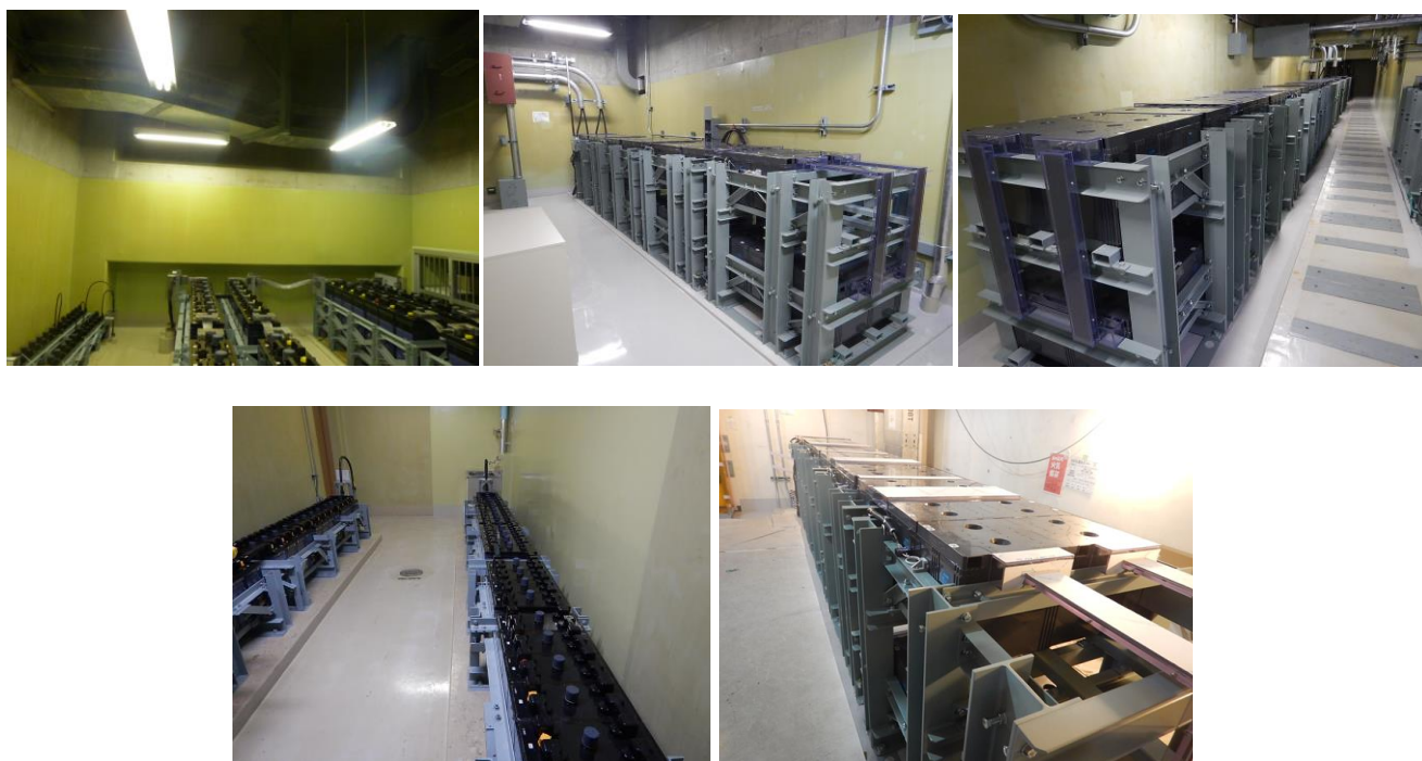
第 41-1-33 図 蓄電池の設置状況 (1 / 9)
