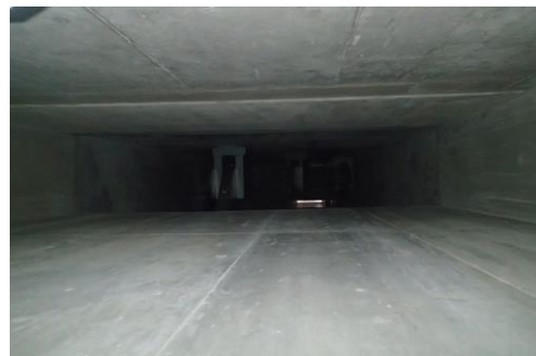
B－給気消音器フィルタ室内
