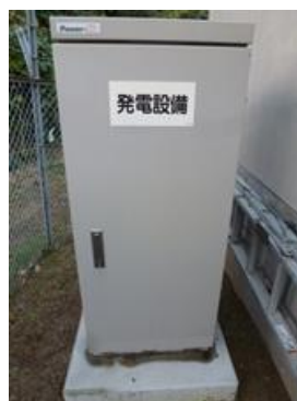
(非常用発電機の写真)
