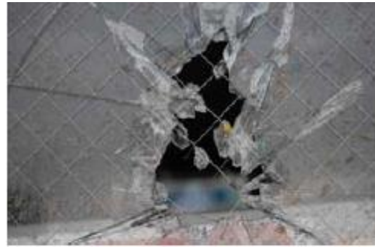
写真 3.4-36 ガラスへの飛来物の衝突痕
