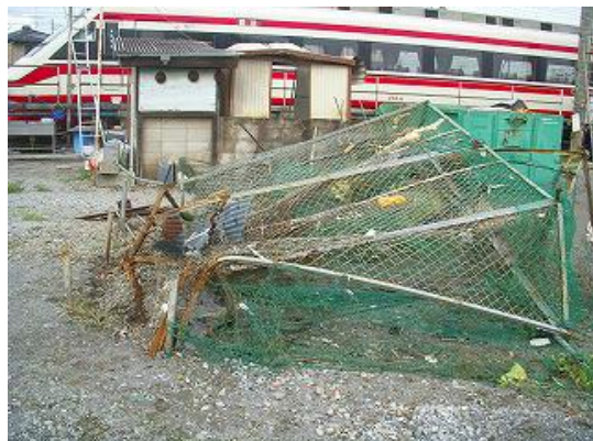
写真20 フェンスの著しい変形
