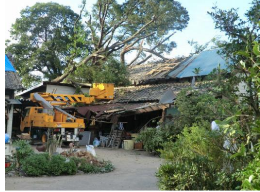
写真 5.1.13 樹木の倒壊による小屋組の被害
