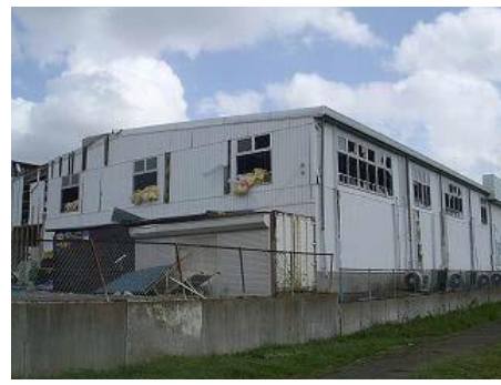
写真 16 窓ガラスの破損
