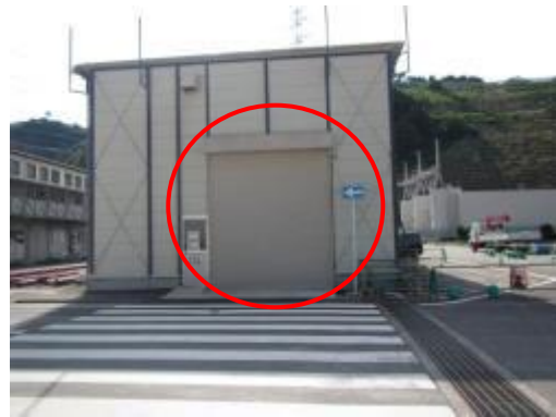
35 日立6号棟シャッター (4.4 m 盤)
