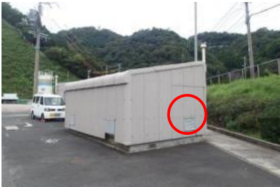
108 危険物屋内貯蔵倉庫給気用格子
