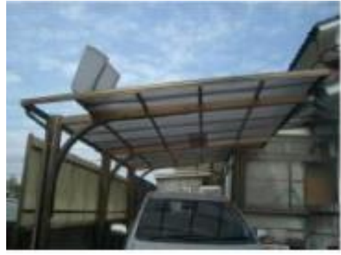
カーボード屋根の破損
