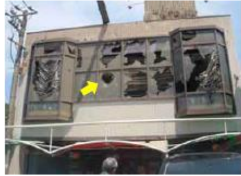
写真 3.4-22 店舗の窓ガラスの被害状況
