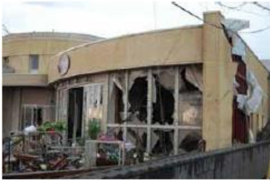
写真 3.4-21 店舗の窓ガラスの被害状況
