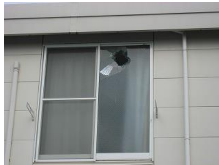
写真 27 窓ガラスの飛来物衝突痕
