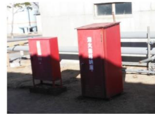
#152 消火設備格納箱
