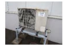
④-14 空調室外機
