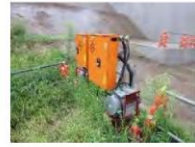
③-3 仮設分電盤
