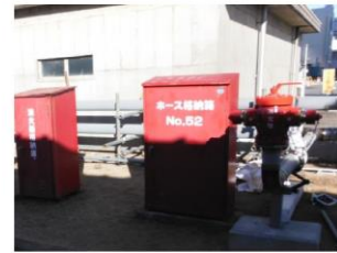
#153 消火設備格納箱
