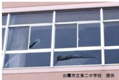
写真 3 体育館窓ガラスの破損
