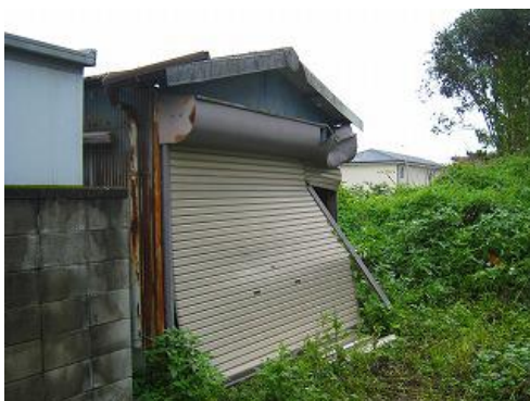
写真 22 シャッターの外れ
