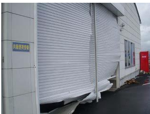
写真 10 シャッターの破損
