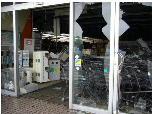
写真 8 エントランスの窓ガラスの破損
