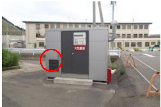
107 危険物屋内貯蔵建物給気用格子
