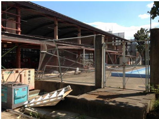
写真 5.2.19 フェンスの被害（工事中の構築物）
