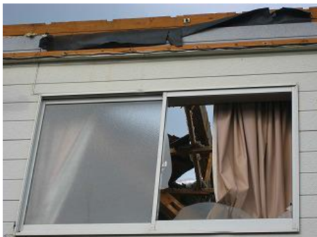
写真 19 窓ガラスの損壊
