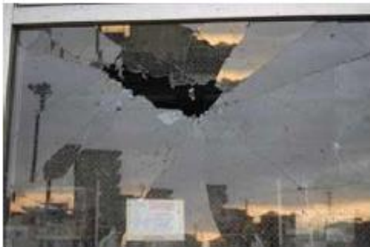
写真 3.4-35 ガラスへの飛来物の衝突痕
