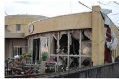
写真3.4-21 店舗の窓ガラスの被害状況
