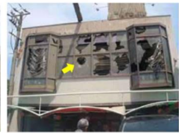
店舗の窓ガラスの被害状況 (飛来物衝突痕)
