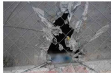
ガラスの被害状況 (飛来物衝突痕)
