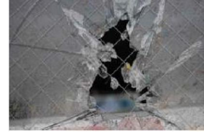
写真3.4-36 ガラスへの飛来物の衝突痕
