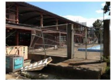
フェンスの変形 (工事中の建築物)
