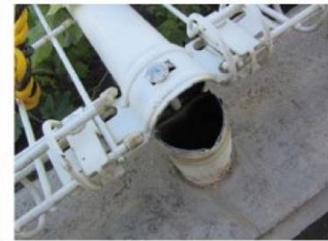
フェンス支柱部の破損
