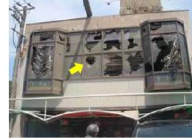
写真3.4-22 店舗の窓ガラスの被害状況
