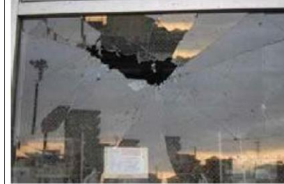
写真3.4-35 ガラスへの飛来物の衝突痕
