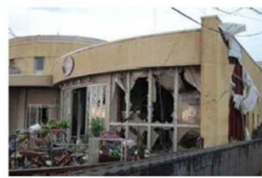
店舗の窓ガラスの被害状況
