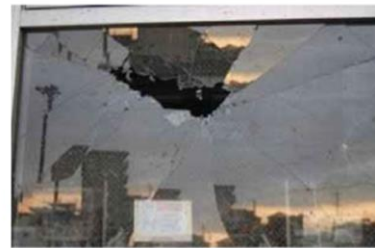
ガラスの被害状況 (飛来物衝突痕)
