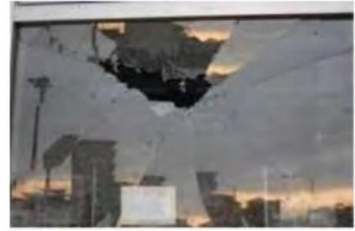
ガラスへの飛来物の衝突痕
