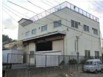
屋上フェンスの変形
