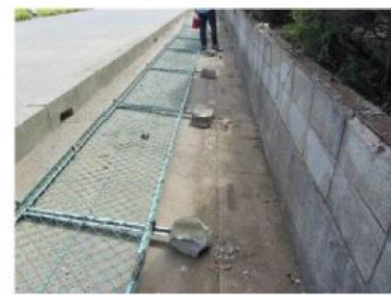
フェンスの倒壊
