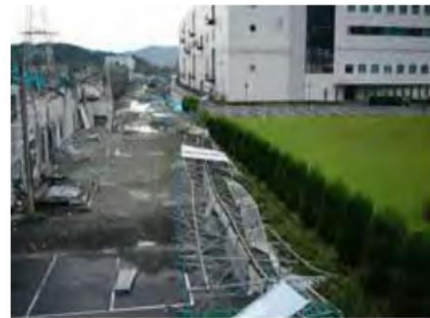
仮設足場の倒壊
