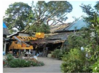
樹木の倒壊による小屋組の被害
