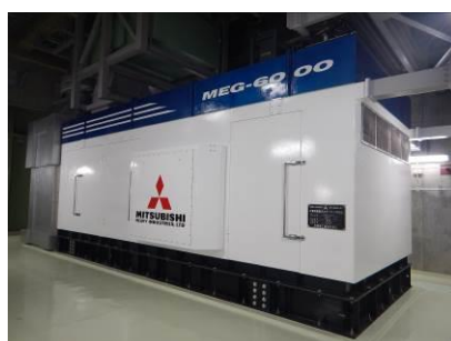
(常設代替交流電源設備の写真)
